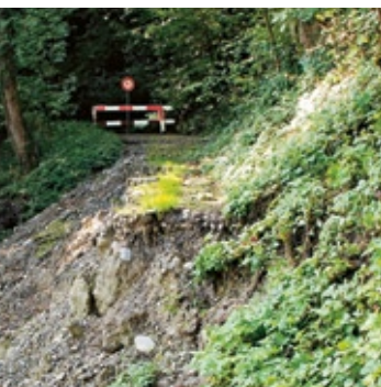
Fig. 92 Glissement de terrain
