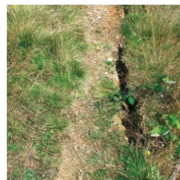
Fig. 5 Fissures du sol
