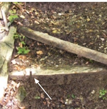
Fig. 86 Dépassement d'un fer d'armature
