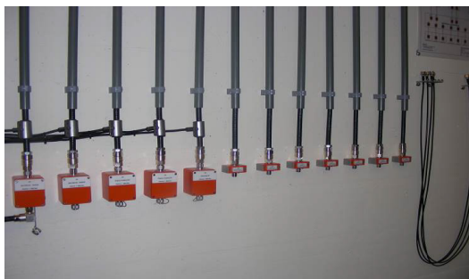
III. 34: Installation radio au centre télématique avec câbles de pontage à droite.
