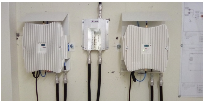
III. 35: Exemple d'un relais actif à large bande Polycom (à gauche), un DIPLEXEUR (au milieu) et un relais à large bande pour téléphonie mobile (à droite).
