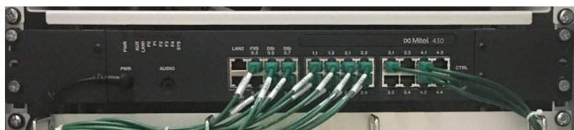
III. 42: Face du Mitel 430 et des commutateurs pour les raccordements externes.
