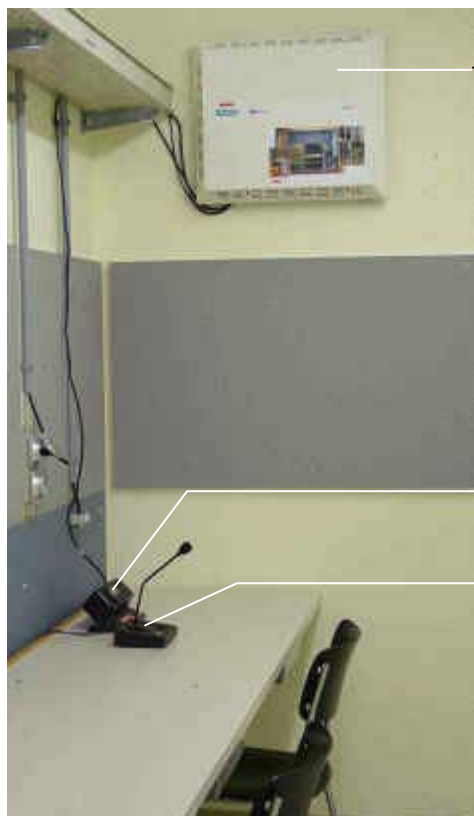
Station fixe montée contre un mur
